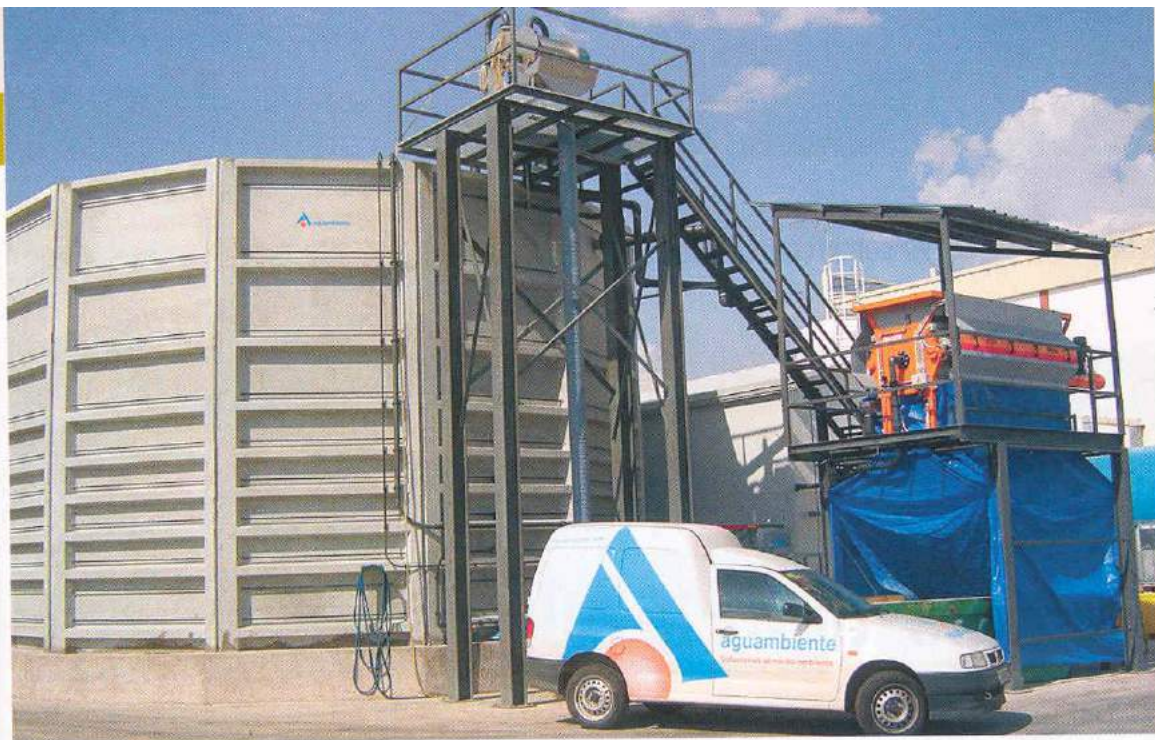
Depuradora de Lavaderos Seseña, instalada en la localidad toledana del mismo nombre.
