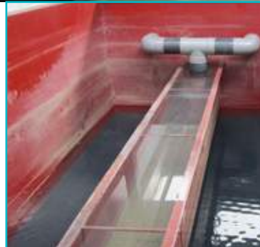
Filtro de arena
