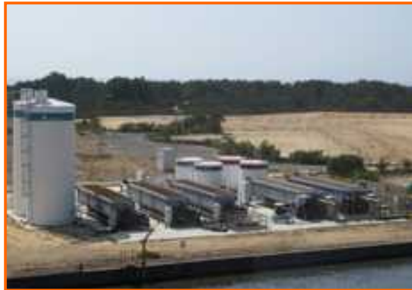
6 Equipos de Flotación por Aire Disuelto
